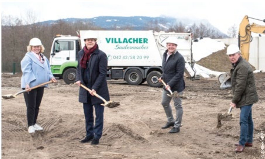
Bürgermeister Günther Albel mit Saubermacher-Chef Hans Roth, Vizebürgermeisterin Irene Hochstetter-Lackner und Stadtrat Harald Sobe beim gemeinsamen Spatenstich zum Ausbau des Standortes in der Drauwinkelstraße.
