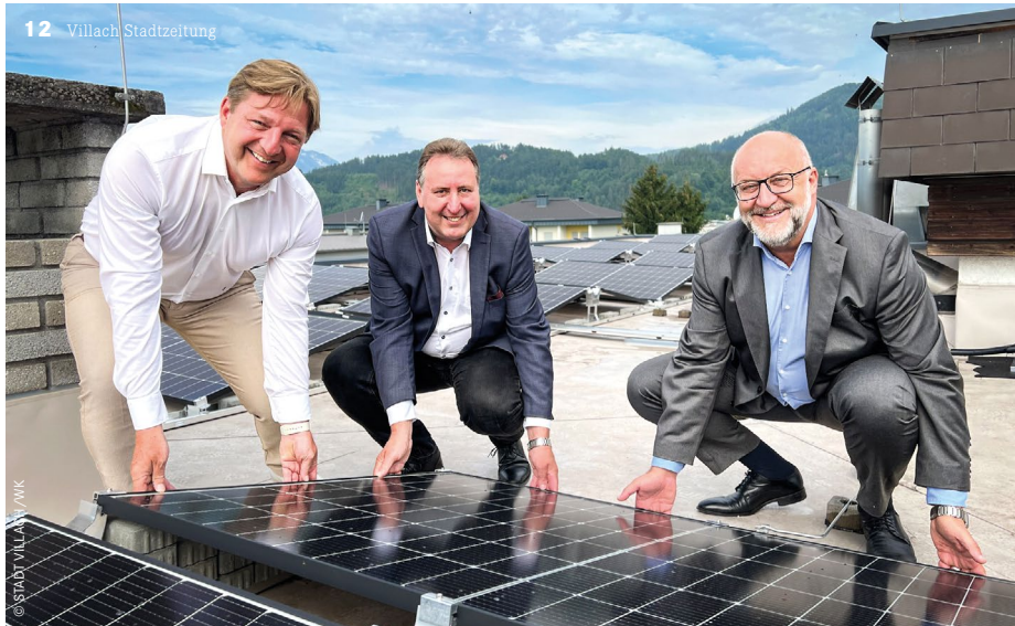
Sonnenstrom: Bürgermeister Günther Albel mit Wohnungs-Stadtrat Erwin Baumann und Stadtwerke-Vorstand Erwin Smole auf dem Dach des Gebäudes Adlerstraße 48
