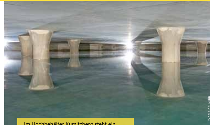
Im Hochbehälter Kumitzberg steht ein Speichervolumen von bis zu 10 Millionen Liter Trinkwasser ständig zur Verfügung.
