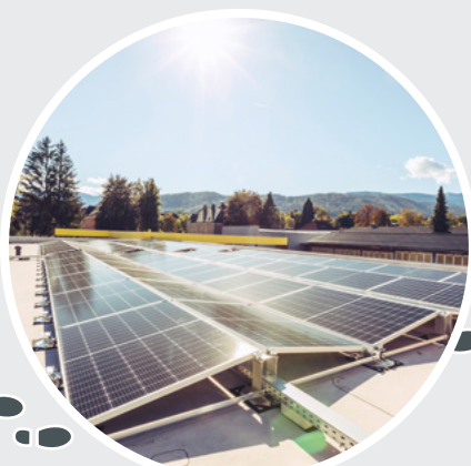
Stadteigener Sonnenstrom spart Kosten und schont Ressourcen.
