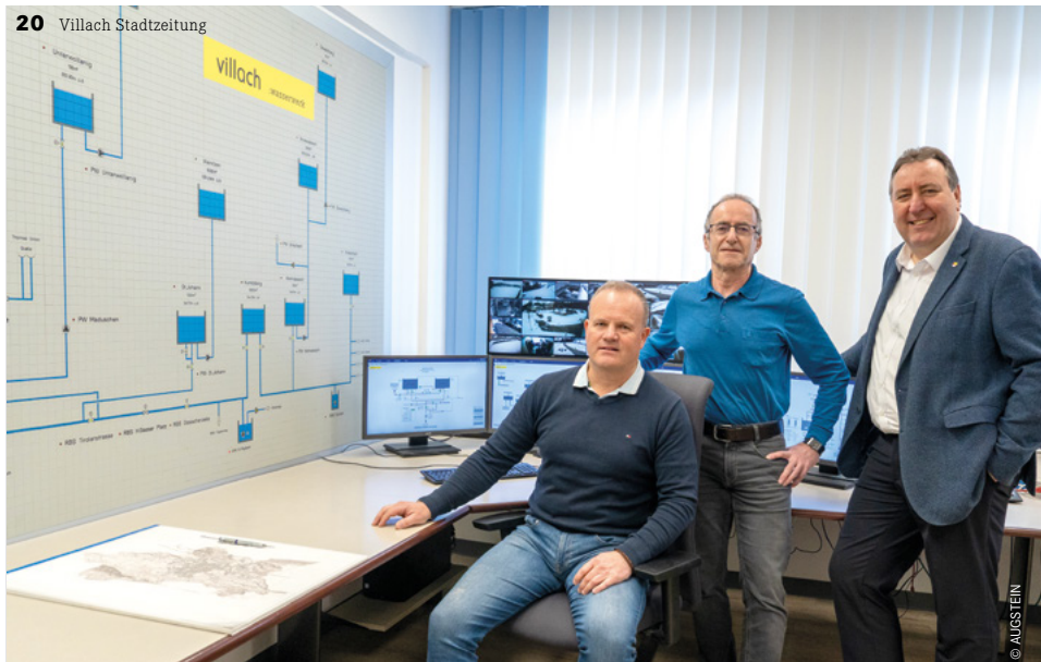
Arthur Lippitsch, Peter Weiß (Leitung Wasserwerk) und Stadtrat Erwin Baumann vor dem Prozessleitsystem, von wo aus die Steuerung der Wasserversorgung erfolgt.
